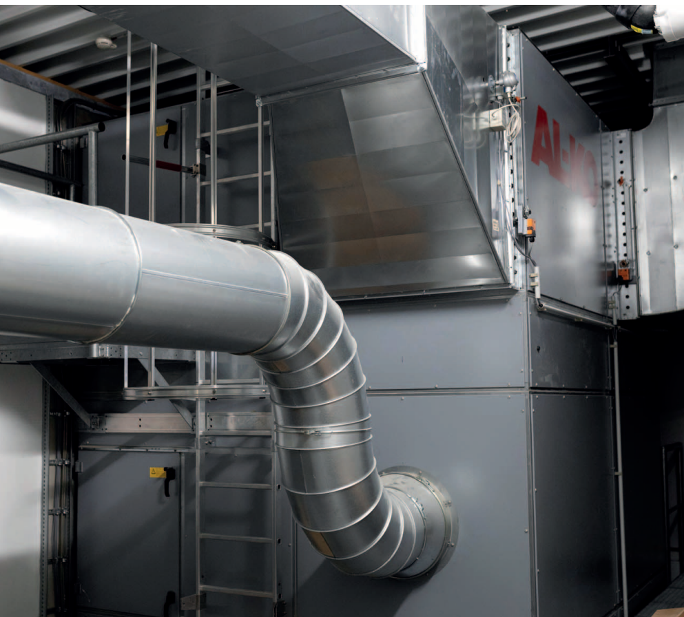
► Eine AL-KO-Profi Jet, ausgelegt für ein Luftvolumen von 30.000m³/h und im Gebäudeinneren installiert, sorgt im Showroom für konstant saubere Luft – energieeffizient und leise.
