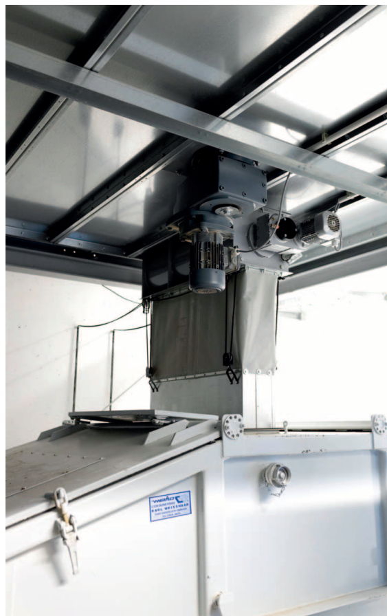
► Per Zellenradschleuse gelangen die Späne und Stäube in einen Container ins Erdgeschoss des Gebäudes.
